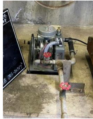
新設原水ブロワ
