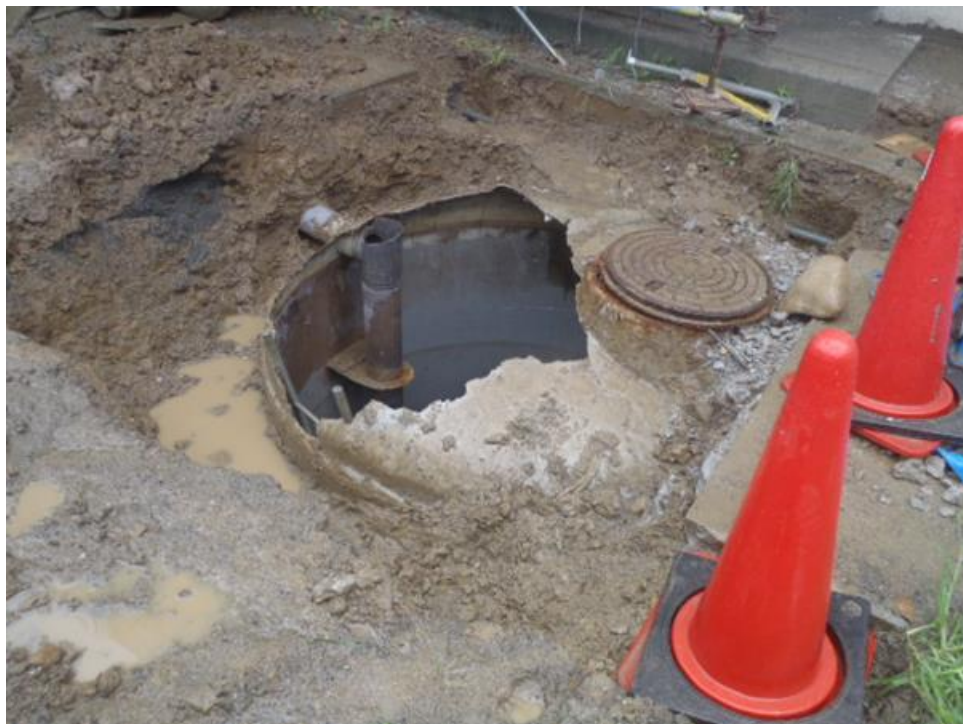
写真2. 2 单独处理净化槽老朽化（破損）事例（80人槽）
