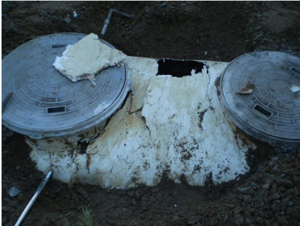
写真2. 1 单独处理净化槽老朽化（破損）事例（7人槽）
